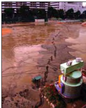
液状化による被害
