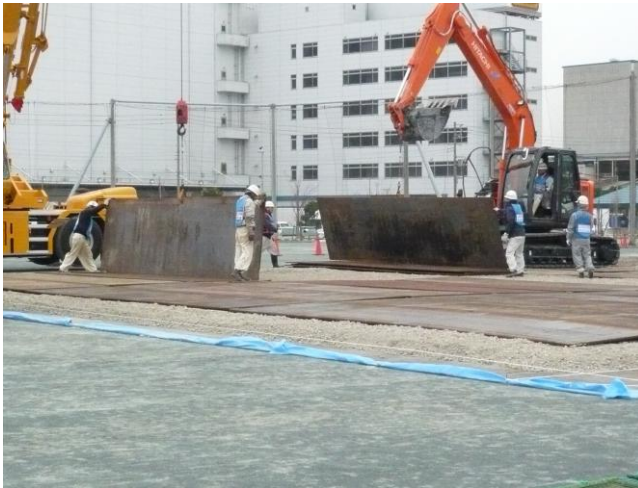
荷捌地応急復旧訓練 ② (砕石と敷鉄板を使用して液状化した地盤を 応急復旧)
